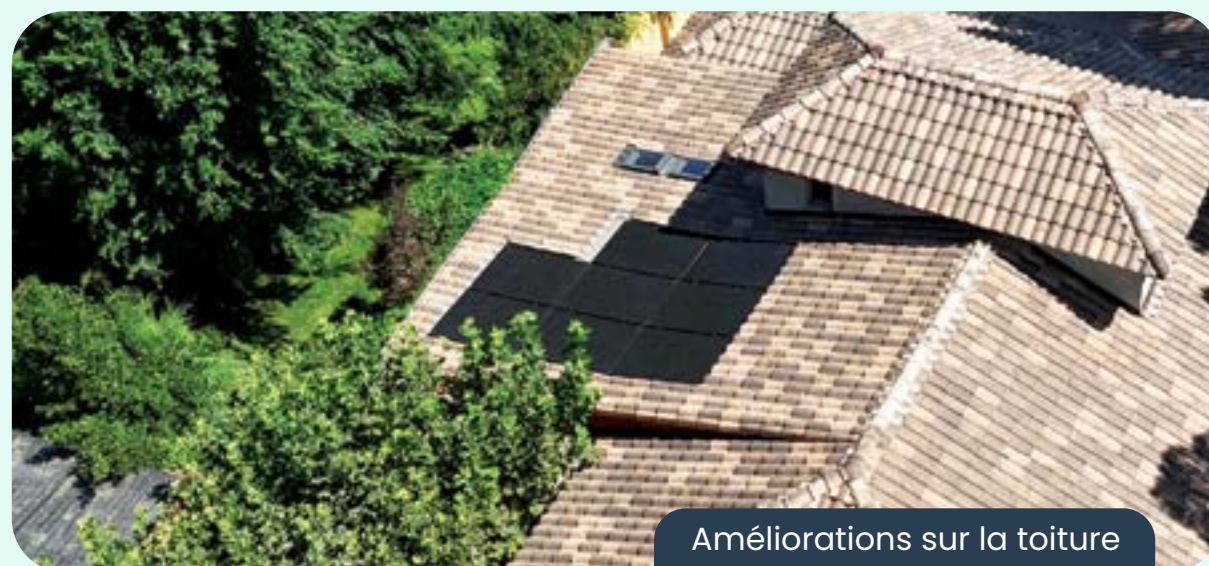
Système d'isolation, intégration de panneaux photovoltaïques
